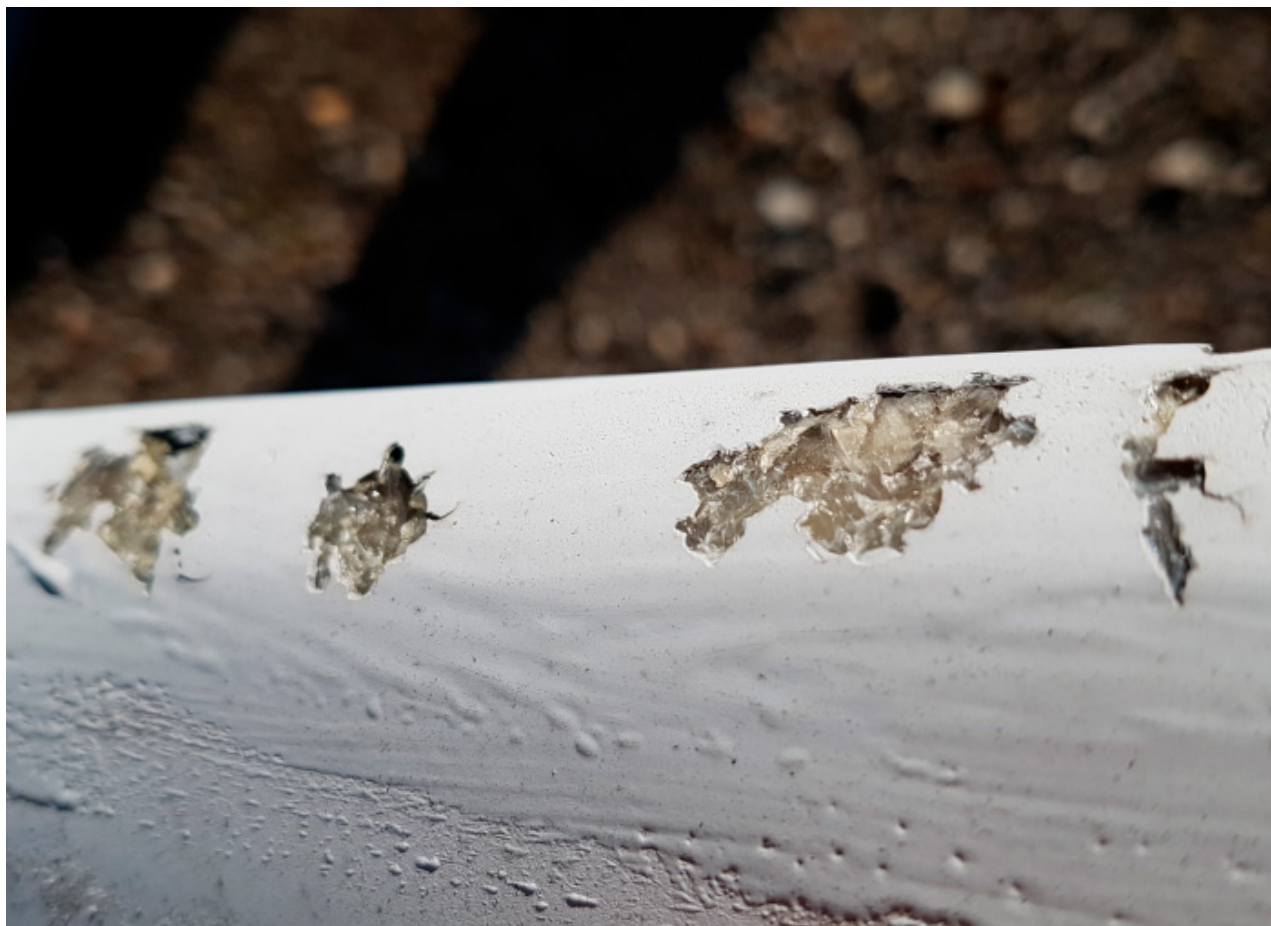
Рис. 14. Эрозия передней кромки лопасти ветряной турбины
